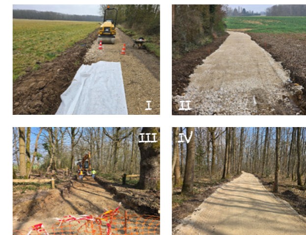
1 et 2 : Vue des travaux en cours de l'itinéraire 10 vers Grand Ambésis 3 et 4 : Vue des travaux en cours de l'itinéraire 10 vers Lévis-Saint-Nom
